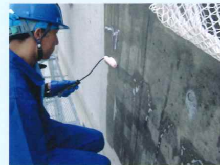
築14年のコンクリート打ち放し建築物への塗布。Sクリートガード®の高い浸透性能がよく分かります。
